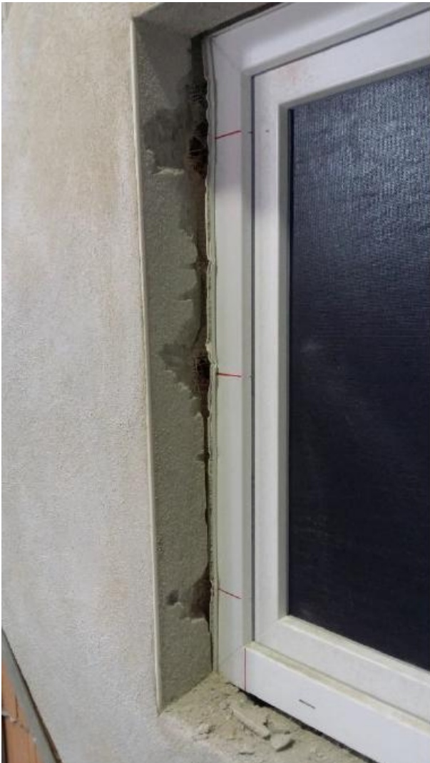
Bild 14: Laibung mit Armierungsputz nach Ende der normativen Versuchszeit für die Widerstandsklasse RC2 in PHLzB8 – 0,65 (Kleinlochung) Wanddicke 365 mm
