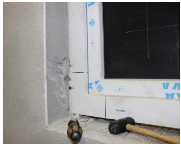
Bild 13: Laibung mit Armierungsputz nach Ende der normativen Versuchszeit für die Widerstandsklasse RC2 in PHLzB6 – 0,5 (Großkammerziegel) Wanddicke 365 mm
